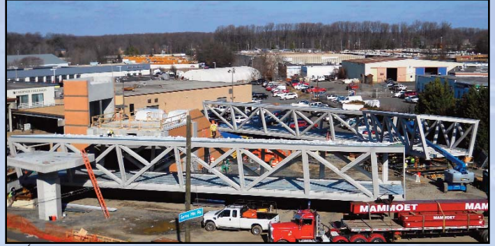
ESTÁ LISTO PARA LANZAMIENTO: Los arcos para los puentes de peatón en la Estación Spring Hill (Tysons Oeste) fueron montados en preparación de levantamiento a través de los carriles de este y oeste de Ruta 7. Foto por Stephen Barna, Proyecto del Metrorail de Corredor Dulles.
