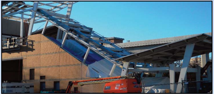
ENTRANDO A UNA ESTACION: La construcción de pabellón de peatón y techo está terminado en la Estación McLean (Tysons Este) a lo largo de Ruta 123. Foto por Stephen Barna, Proyecto del Metrorail de Corredor Dulles.
