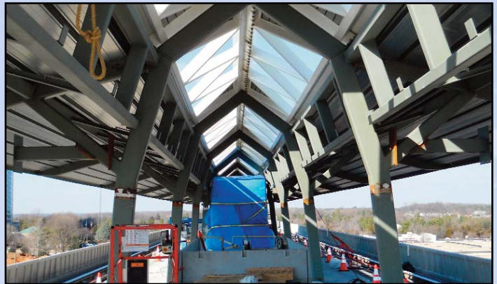
EN LA ESTACION SPRING HILL (TYSONS OESTE): El armazón para el toldo de la Estación Spring Hill está terminado. Foto por Stephen Barna, Proyecto del Metrorail de Corredor Dulles.
